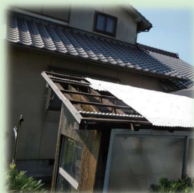
屋根の剥がれ
