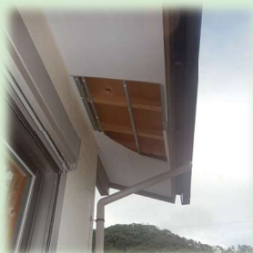
軒天の剥がれ
